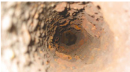
Vue intérieure d'un tuyau DN 100 atteint de corrosion
